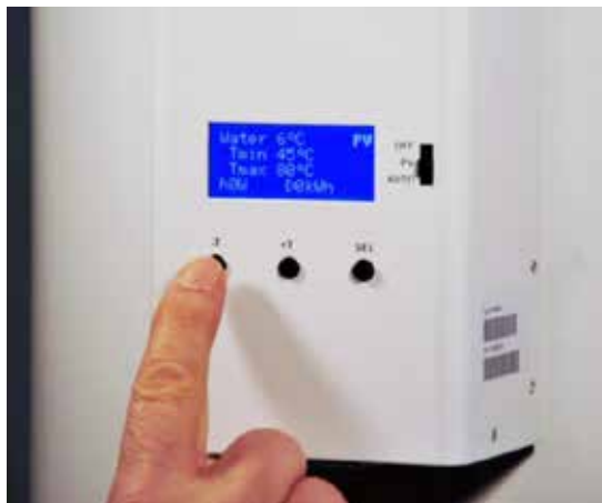
Abb.3 In jeder Wohnung liefert ein SELACAL-Controller Solarenergie für den Warmwasser-Speicher
