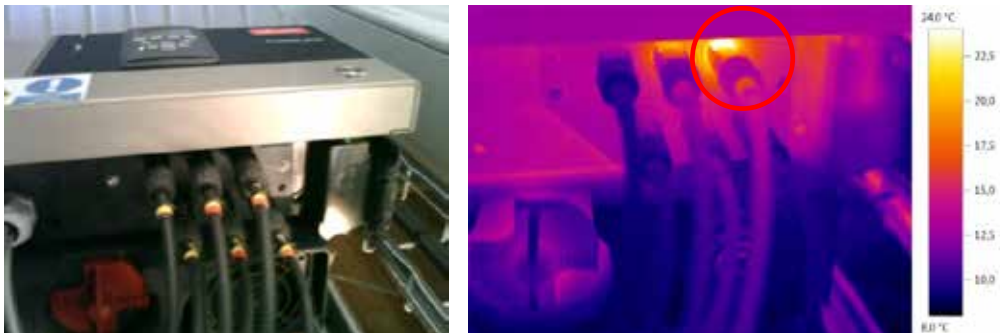
Abb. 13: Bild (links) und TG Bild (rechts) eines Wechselrichter in Betrieb
