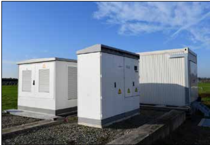
Abb. 9: Batteriewechselrichter SCS 500, SMA mit Batteriecontainer und Transformatorstation
