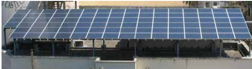
Abb. 5: Foto PV Generator (Gesamtansicht)
