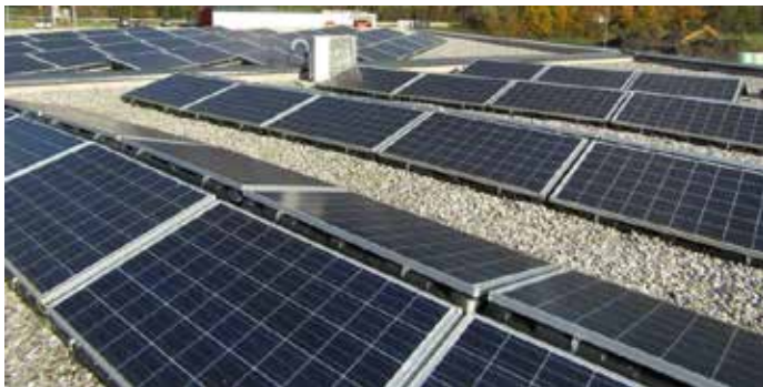
Abb. 11: PV Generator mit Minderleistung nach Hagel (Module sehen aus wie neu)
