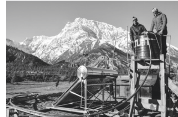
Abbildung 3 Projekt Warmwasseranlage an der Lophelling-Schule (Nepal)
