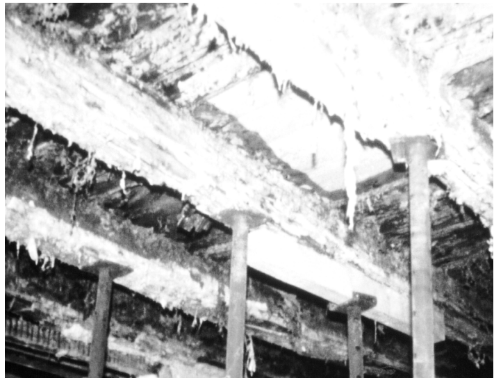
Bild 5 Vom Hausschwamm befallene Holzbalkendecke [11]
