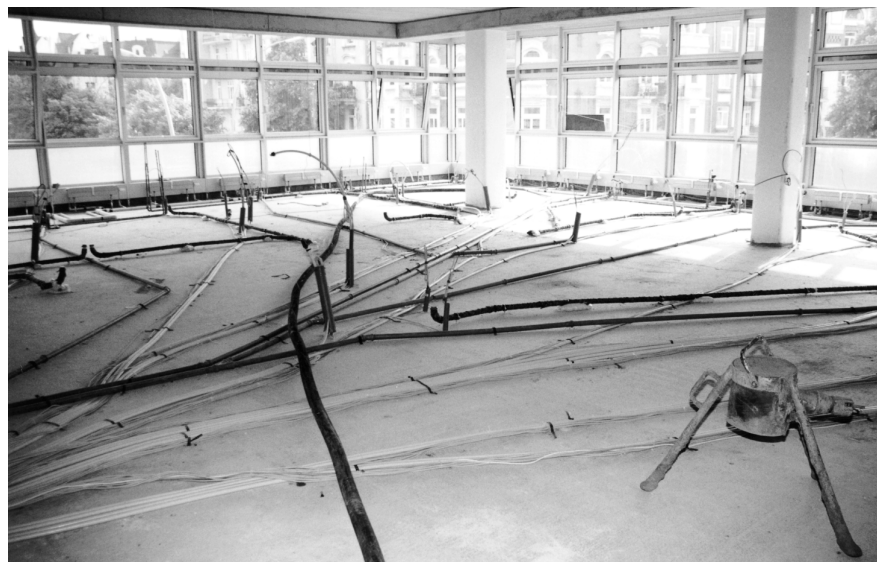
Bild 3 Rohrwirrwarr auf der Betonplatte [6]
