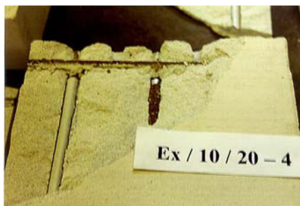
Abb. 4.2.4.11 Lokale Zerstörungen unterhalb des Verankerungsstabes ( d_{sA} 10mm; e=20 mm)
