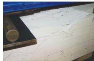
Abb. 6.1.1.10 Detail: Schollenartige Abplatzung des Porenbetons in der Balkendruckzone (VI/3/13/4A_5 mit einem Bügelabstand s_w=20\text{cm} )
