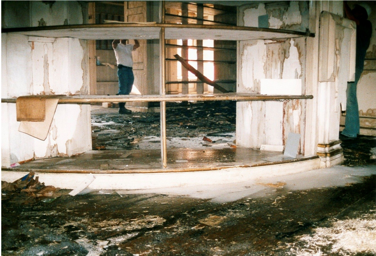
Abbildung 2 : Die Grundebene des Rokokosaals nach dem Brand. Die Bücher, die hier und auf der ersten Galerie des Saals standen, trugen vor allem durch Hitze und Löschwasser mehr oder weniger schwere Schäden an den Einbänden davon. Sie werden im Rahmen der Mengenrestaurierung in der Mehrzahl von externen Auftragnehmern bearbeitet. Foto: KSW/HAAB
