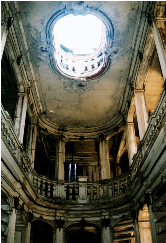
Abbildung 1: Der Rokokosaal nach dem Brand vom September 2004. Die Grundebene und die erste Galerie des Saals wurden stark beschädigt, die zweite Galerie und das Dach vollständig zerstört. Vom Saal aus blickt man direkt in den Himmel. Foto: KSW/HAAB
